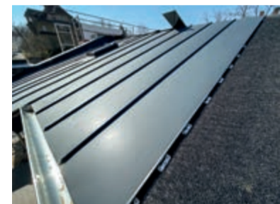
Zur Hinterlüftung der Aluminium-Scharen in anthrazit verlegten die Dachhandwerker zuvor eine Trennlage aus diffusionsoffener Unterdeckbahn mit Polypropylen-Mono Filament Gelege.
