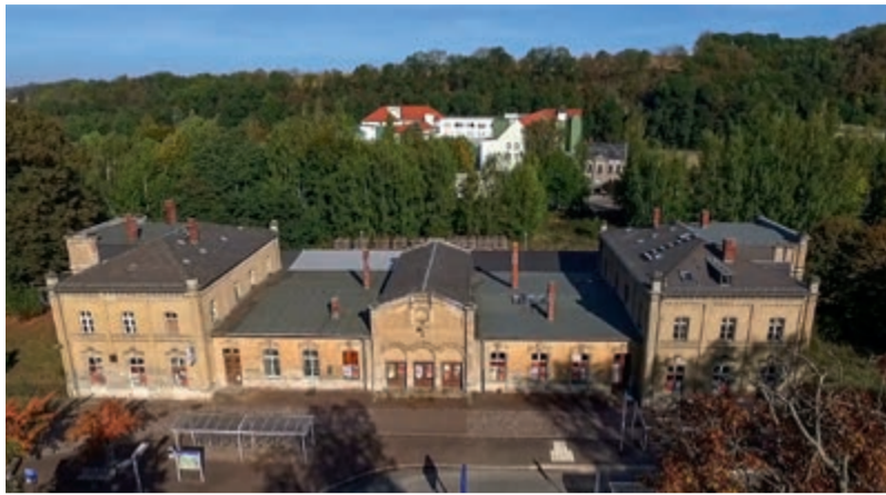
Blick auf das noch unsanierte Dach des Bahnhofgebäudes. © Fotos: puren
