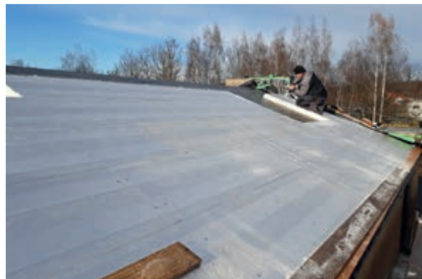
Fixierung der einzelnen Dämmplatten des MetalFix-Systems durch die integrierten Mehrschichtholzleisten hindurch in der Tragkonstruktion.
